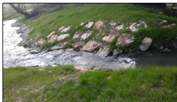
Photo de la prise d'eau d'un bras de contournement créé pour contourner un clapet - Clouère à Brion, 2013 (SMVCS)
