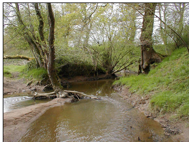
Arbres dans le lit à retirer car il développe un atterrissement.
