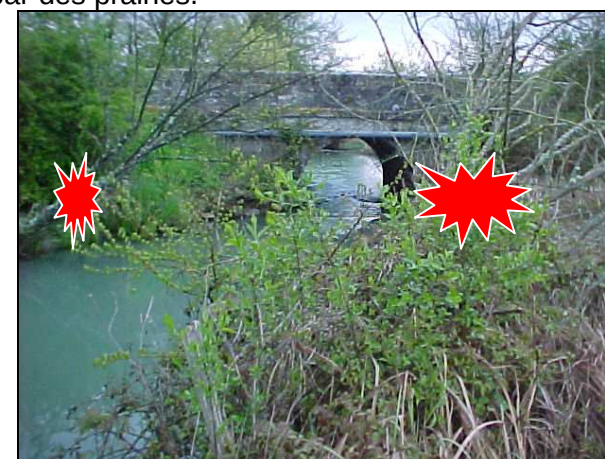
Le pont de la D.100 : des Ormes morts sont à abattre
