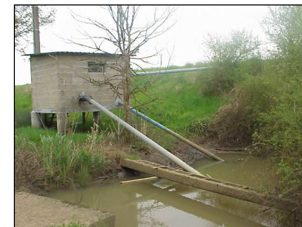
Pompage, à l'Epine
