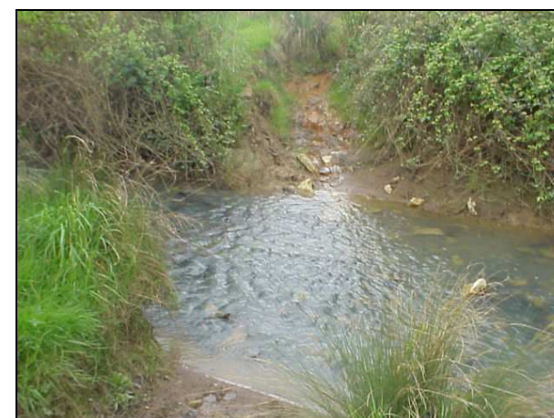
Passage à gué provoqué par du gibier au niveau d'un radier, au droit de Verrerie
