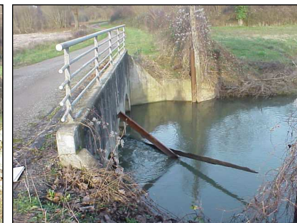
Barres métalliques dans le lit, pont de la route allant de la Raffinière à la D7
