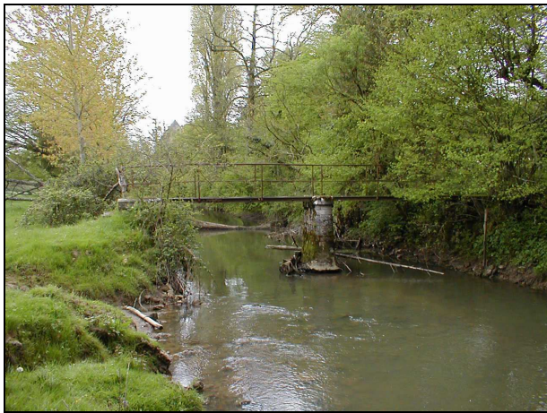
Passerelle, embâcle et arbre en travers
