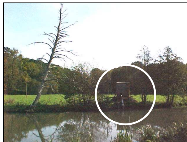
Installation de pompage fixe en rive droite en amont du moulin de la Planche et arbre mort à couper.
