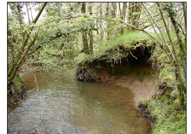
Erosion de berge en aval du pont consécutive à la chute d'eau.
