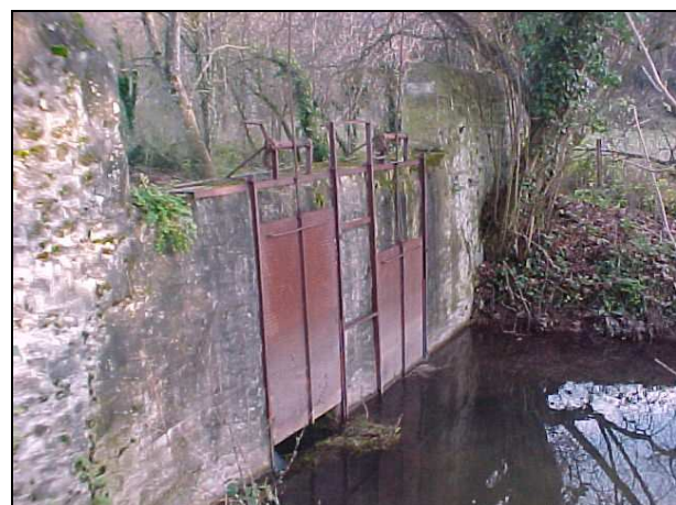
Vannes de régulation à l'entrée du bourg.
